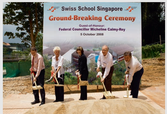
Der Spatenstich; ein denkwürdiger Moment für die Schweizer Schule Singapur. Von links nach rechts: Max Meyer (Projektleiter), Rebekka Aicher Koch (Präsidentin des Schulkomitees), Bundesrätin Micheline Calmy-Rey, Jörg Al. Reding (Schweizer Botschafter in Singapur), Martin Silberstein (Präsident des Schweizer Clubs).
