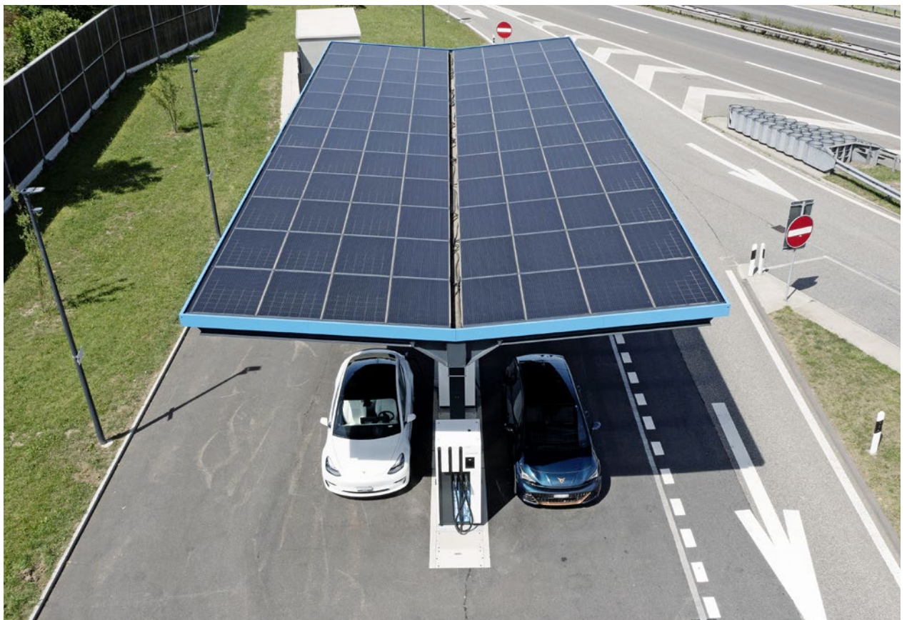
Der Ausbau der Elektromobilität lässt den Stromverbrauch steigen. Eine der Schlüsselfragen: Wie umweltfreundlich ist der getankte Strom? Diese Ladestation bei Oftringen (AG) ist mit Solarzellen bestückt. Foto Keystone
